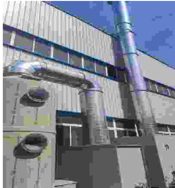
图3-2 水喷淋+活性炭+排气筒P1
